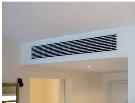
Rejilla de suministro de aire acondicionada
